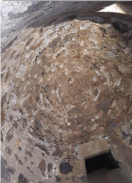
La voûte du corps de la glacière et le débouché de la trappe à glace.
